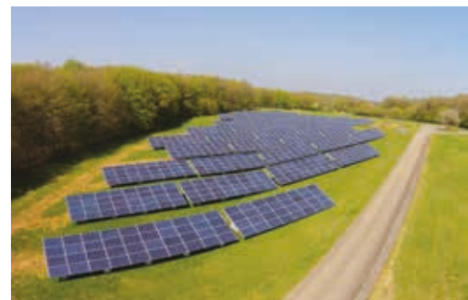
Fotovoltaïsche panelen van het KMI in Dourbes (Publiek-private samenwerking: Fedesco/Regie der Gebouwen).
