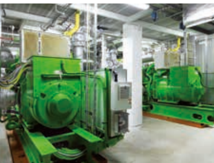
Warmtekrachtkoppeling op de Jubelparksite (Publiek-publieke samenwerking: Sibelga/Regie der Gebouwen).
